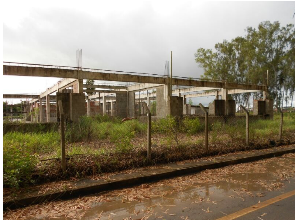
No CCS, as marcas na construção e o mato crescente mostram que há muito se espera pela finalização da obra.
