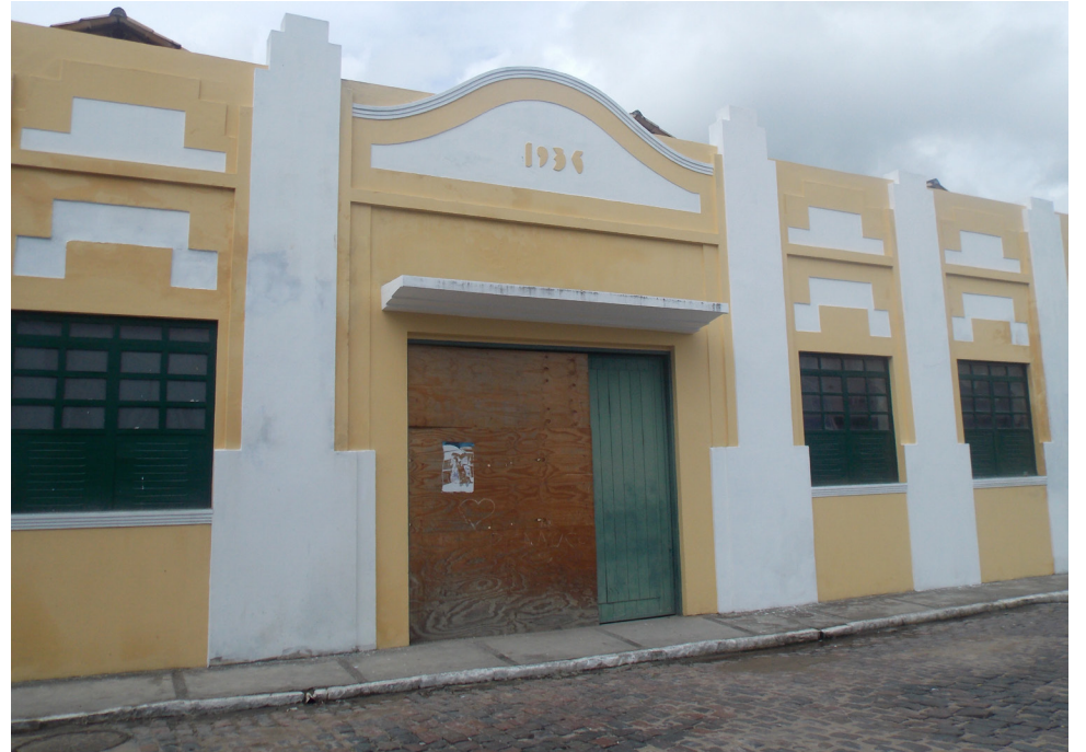
No dia 14 de março de 2013, um carro desgovernado bateu no portão lateral do CAHL. Até o momento, a reforma não contemplou um novo portão.
